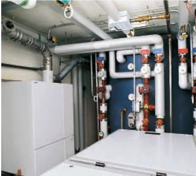
Une chaudière à condensation à gaz de 60 kW couvre les besoins de pointe
