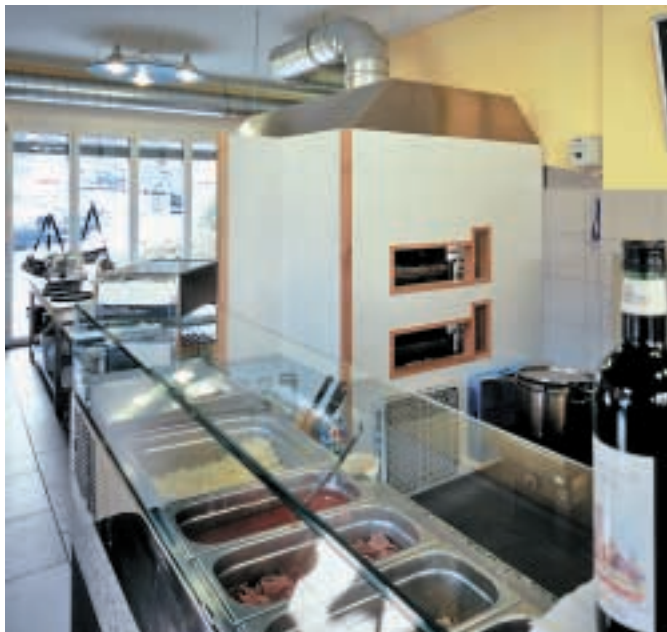
Le four à pizzas a dû être isolé phoniquement côté paroi du local
