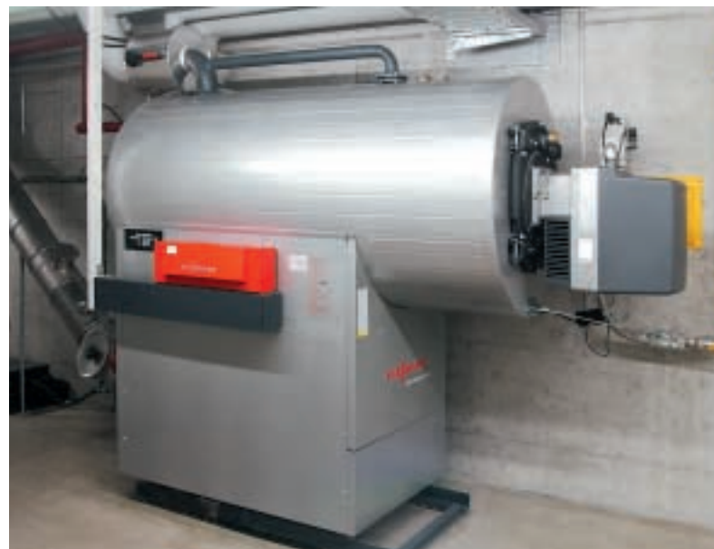
La chaudière à condensation de 500 kW avec brûleur modulant à air soufflé à gaz
