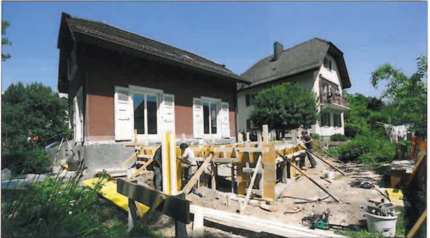
Avant travaux, la maison n'était pas isolée et ne répondait plus aux normes en vigueur.
